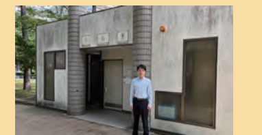
修繕を要望した緑町中央公園のトイレ
